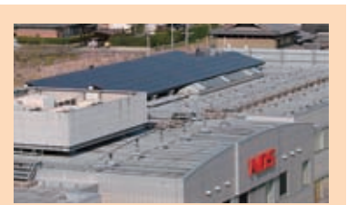
写真3 太陽光発電設備 (テクノロジー総合センタ)
