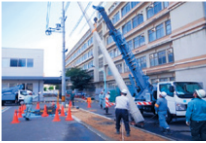
写真7 通信線路建設技術科（電柱）
