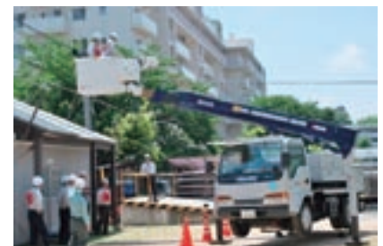
写真10-② 地盤養生不良危険体感
