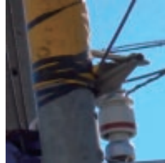
ii) 模擬電柱によるクランプカバーの損傷再現
