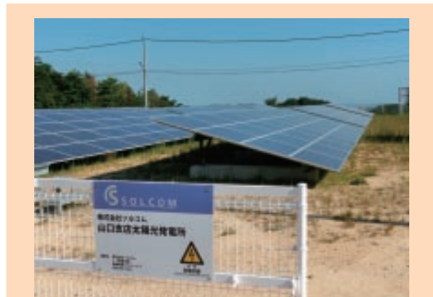
図9 山口支店の太陽光発電設備
