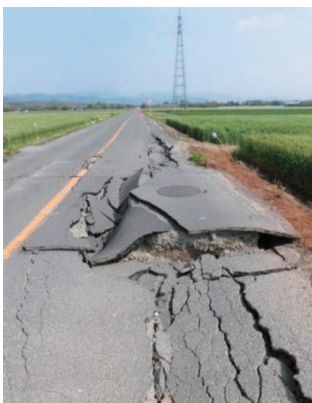
道路の隆起・陥没
