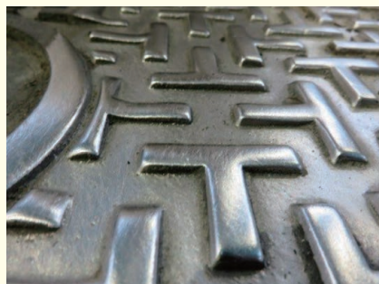
試験後の摩耗した鉄蓋
