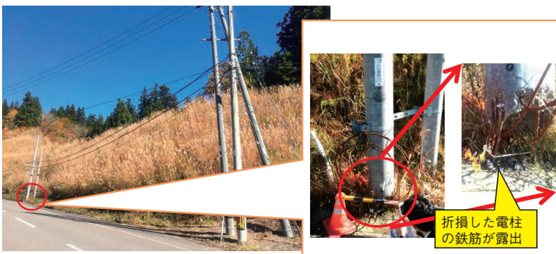
図1 雪害の発生現場と、折損したコンクリート製電柱の様子
