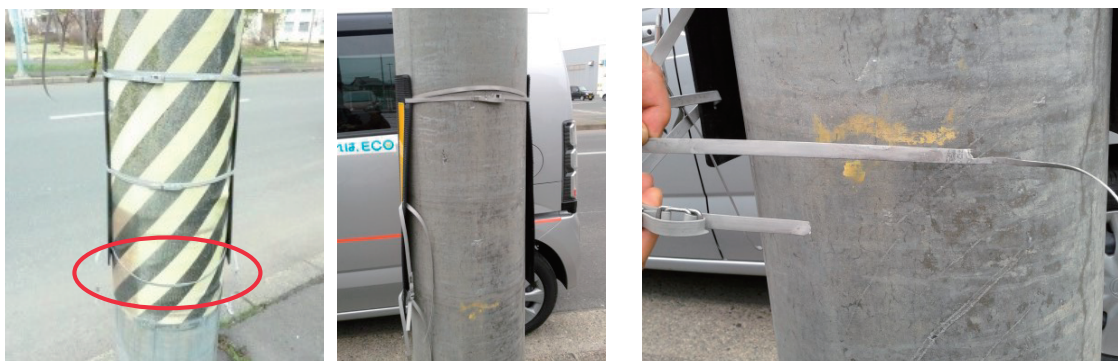
図1 電柱標識板とビニルバンドの破断
