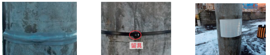
図7 対策案（左より、①定型シーリング剤、②パワーバンド、③反射シート）
