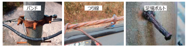
図4 高塩害地域の腐食例
