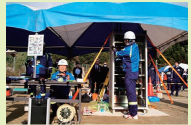
写真15 HO架内作業における養生材破損事故実演
