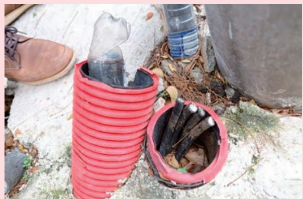
切断され放置されている引上管
