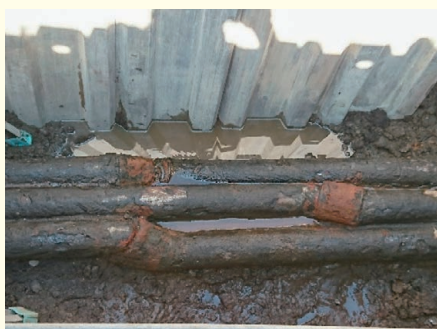
図1 管路被災事例
