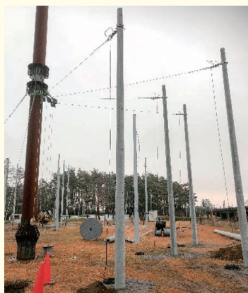
図1 土壌影響「有り」の検証設備
