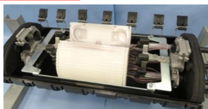
浸水改修対象の7号スタンダードクロージャ 例：7B号加入光用スタンダードクロージャ「L-4」
