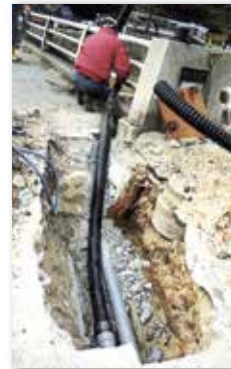
西宮市内を流れる「夙川」に架かる添架管路が被災、仮管路で中継ケーブルを引替えた
