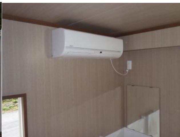
エアコン配備
